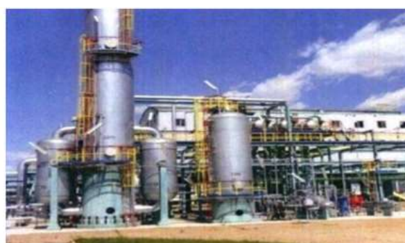
Instalația de piroliză Pitești
